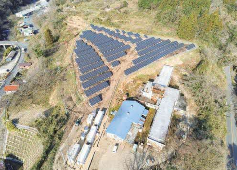
▲防災拠点整備事業で設置した太陽光パネル(旧邑智中学生寮付近)
