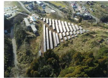
500kW 四日市太陽光発電施設
